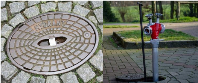
Klassischer Unterflurhydrant und Standrohr.
